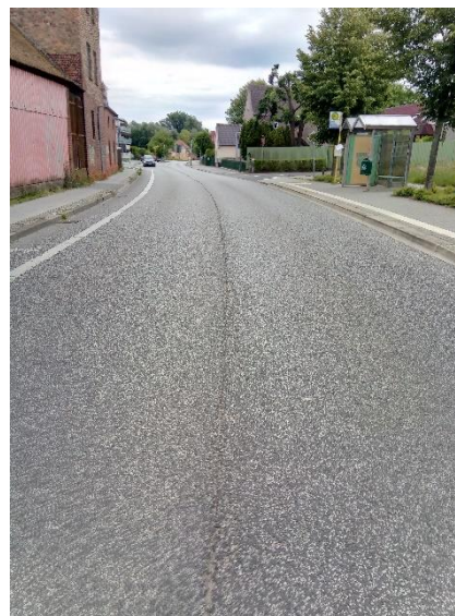
Abbildung 21 Gesamtansicht mit Riss in der Fahrbahnmitte
