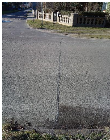
Abbildung 45 Graphische Darstellung eines Risses in der Fahrbahndecke
