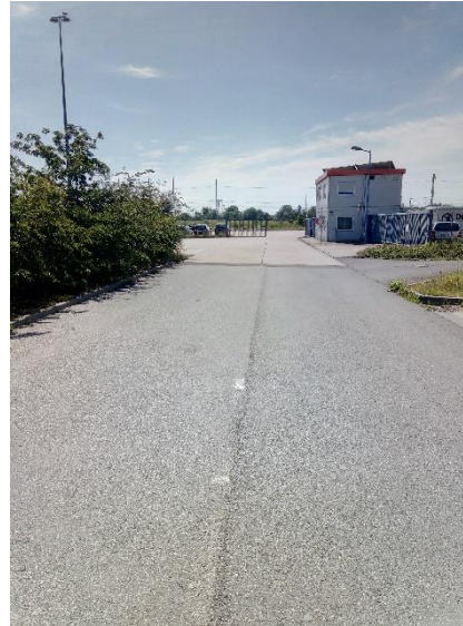
Abbildung 23 Gesamtansicht mit Riss in der Fahrbahnmitte
