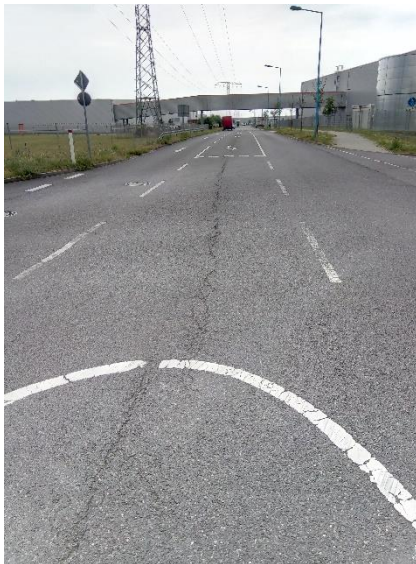
Abbildung 14 Gesamtansicht mit Rissbildung
