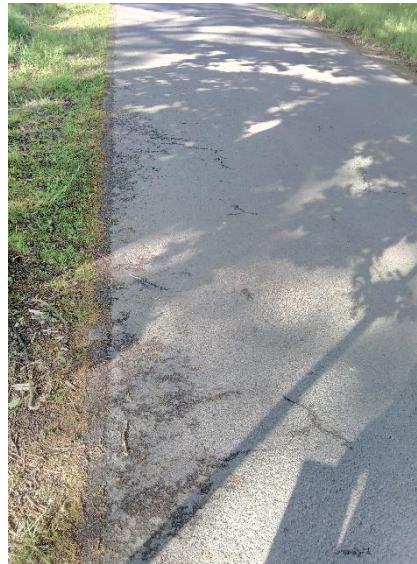
Abbildung 121 Gesamtansicht mit Rissbildung
