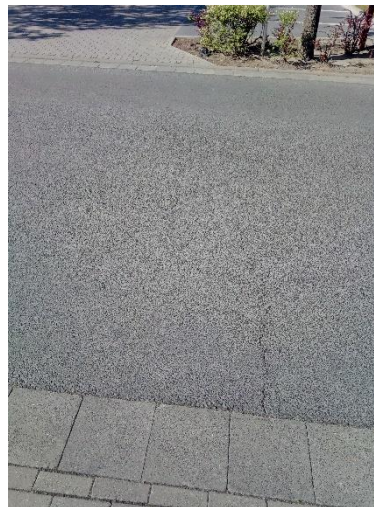
Abbildung 5 Rissbildung in der Fahrbahndecke
