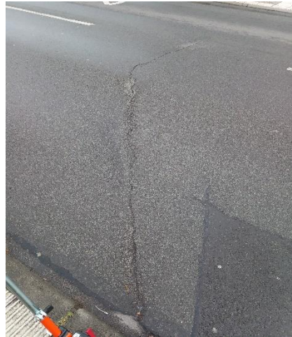
Abbildung 3 graphische Darstellung eines Risses in der Fahrbahndecke
