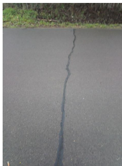
Abbildung 145 Graphische Darstellung eines Risses in der Fahrbahndecke
