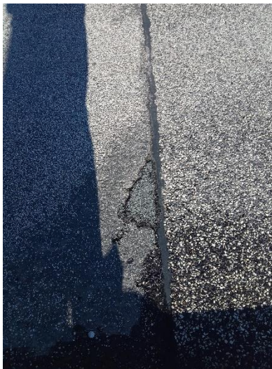
Abbildung 42 Darstellung eines Risses in der Fahrbahndecke
