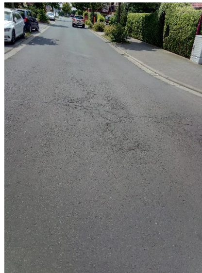
Abbildung 25 Gesamtansicht mit Netzrissen
