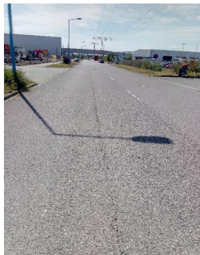
Abbildung 29 Gesamtansicht mit Rissbildung
