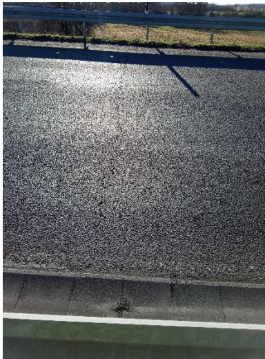
Abbildung 44 Graphische Darstellung der Risse in der Fahrbahn
