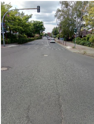
Abbildung 26 Gesamtansicht mit Rissbildung Hoppenrader Allee
