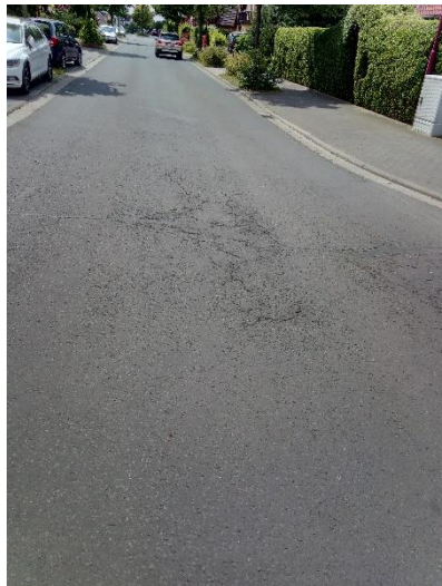
Abbildung 27 Gesamtansicht mit Netzrissen
