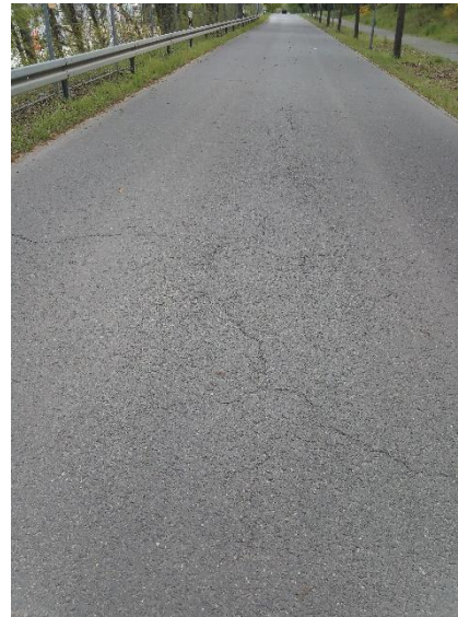
Abbildung 73 Darstellung der Netzzrisse in der Fahrbahndecke
