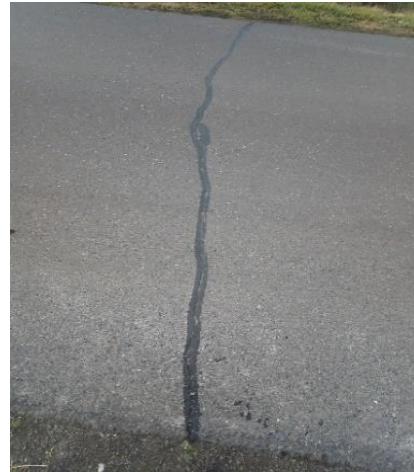
Abbildung 57 Exemplarisch Riss in der Fahrbahndecke
