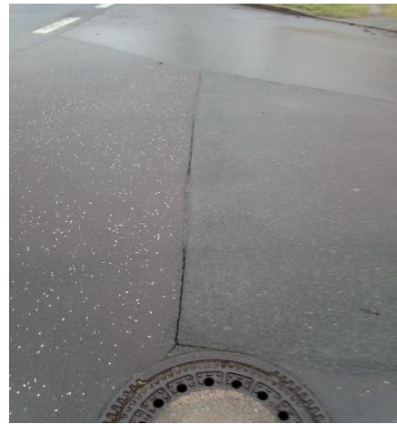
Abbildung 139 Graphische Darstellung eines Risses in der Fahrbahndecke
