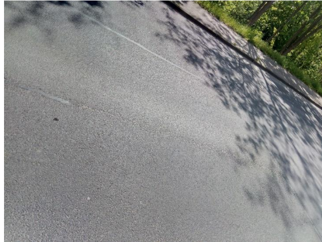
Abbildung 89 Rissbildung entlang der Fahrbahnoberfläche
