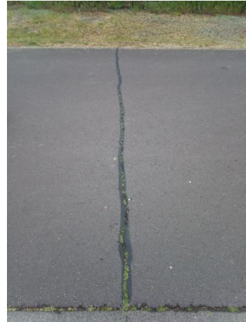
Abbildung 131 graphische Darstellung der Rissbildung in der Fahrbahndecke
