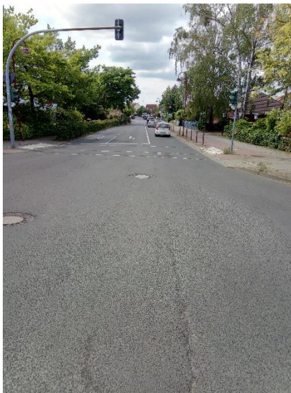
Abbildung 24 Gesamtansicht mit Rissbildung Hoppenrader Allee
