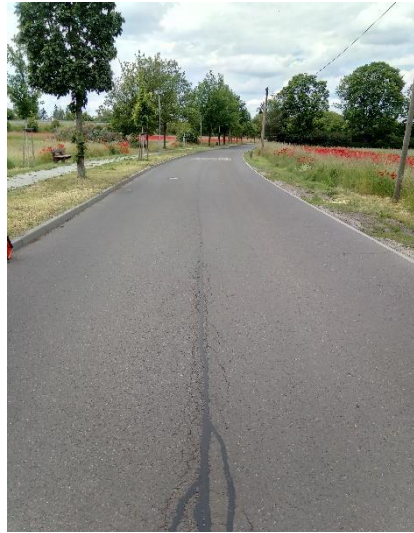
Abbildung 35 Gesamtansicht mit Rissbildung in der Fahrbahnmitte
