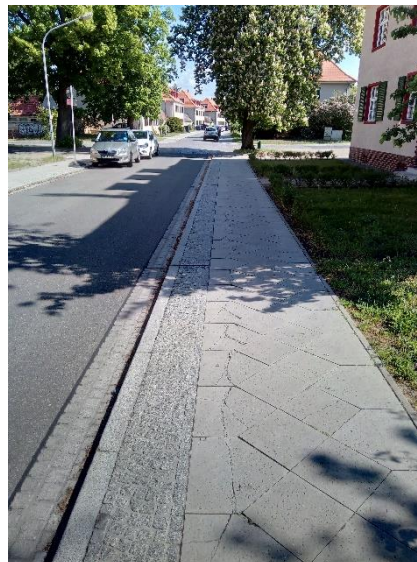
Abbildung 115 Gesamtansicht mit Rissbildung im Gehwegbereich
