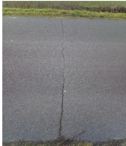
Abbildung 61 Riss in der Fahrbahndecke
