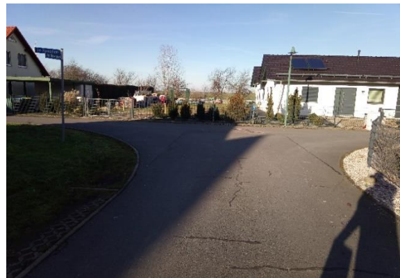
Abbildung 55 Graphische Darstellung der Risse in der Fahrbahn
